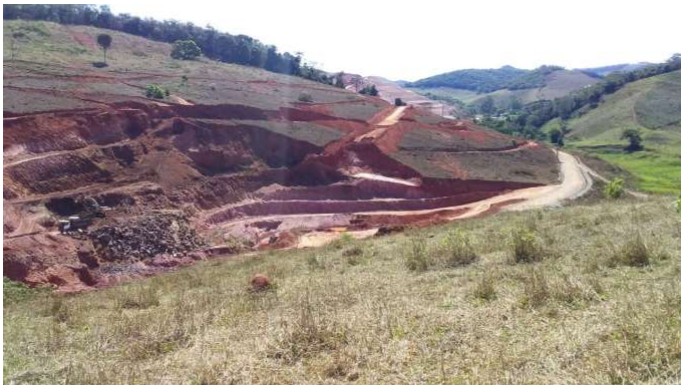
Figuras 13 e 14 – Situação da intervenção na referida área no dia 28 de setembro de 2020.
